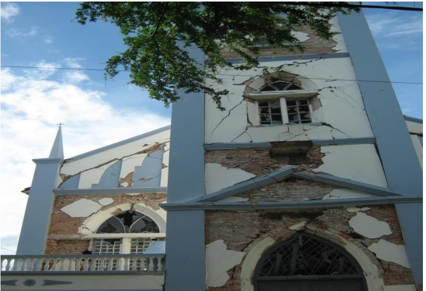
Foto: Rumah Ibadah Nasrani yang remuk di kota Padang akibat gempa bumi 30 September 2009 itu
