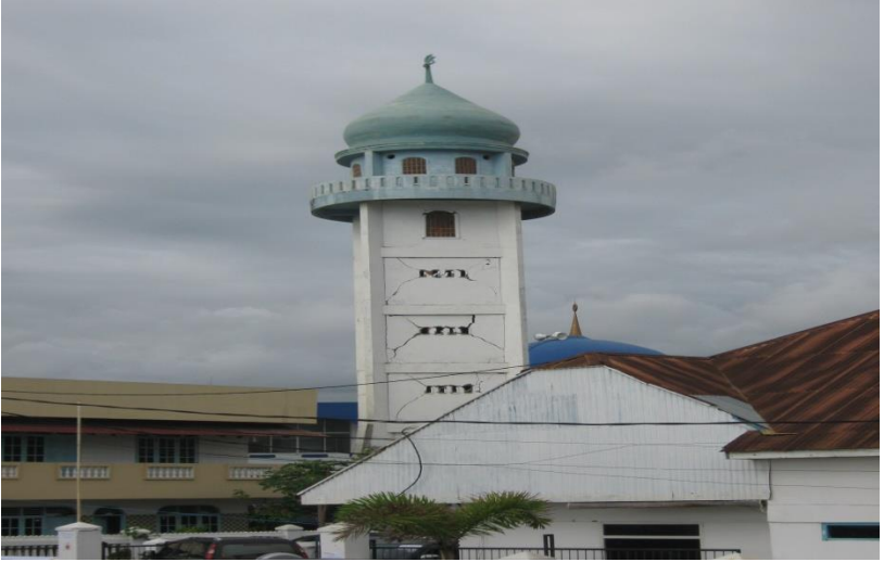
Foto: Retaknya di Menara Masjid tempat hari-bari azan dikumandangkan
